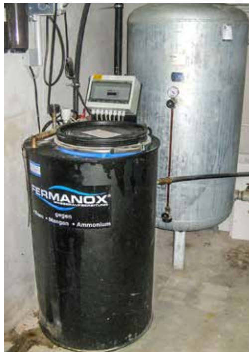
Bei der unterirdischen Enteisung im Brunnen wird Wasser in einem Zwischenbehälter mit Sauerstoff angereichert und zurück in den Brunnen geleitet. Fotos: Alfons Fübbecker
