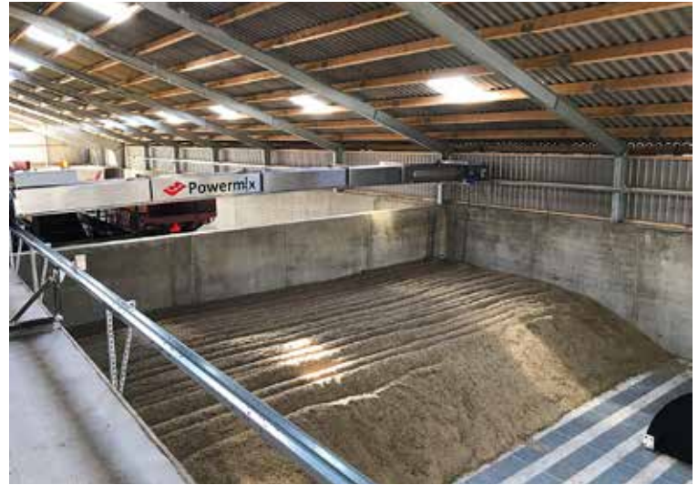
Schnell-trocknungszelle mit Mischtraverse
