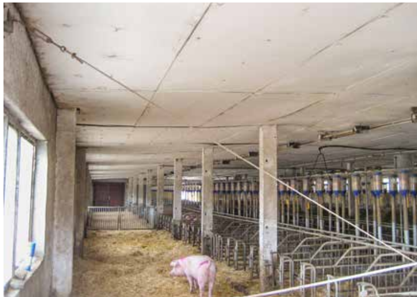
Auch Altgebäude können gut für die erste Phase nach dem Absetzen genutzt werden. Foto: Christian Meyer
