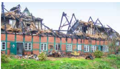
Brand nach einem durch Tierbiss verursachten Kurzschluss
