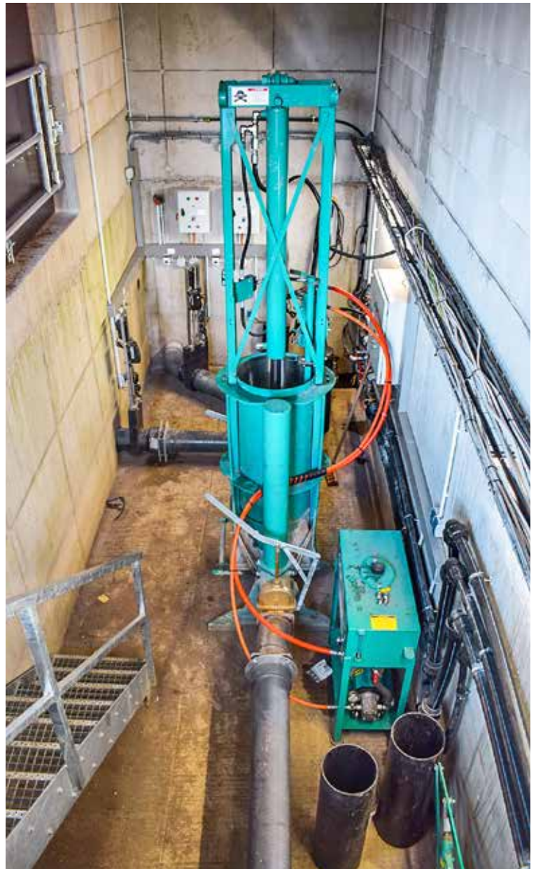
Blick in den Technikraum mit Hubkolbengülpumpe und automatischen Schiebern im Hintergrund
