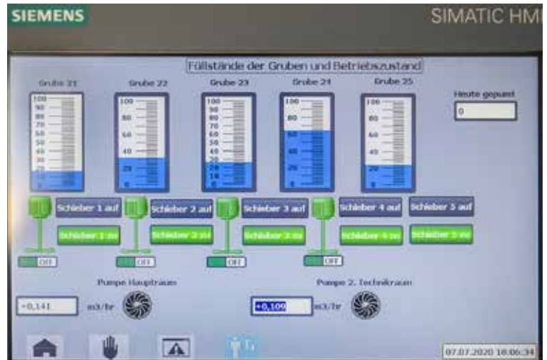
Das Herzstück der Gülleanlage: Füllstandüberwachung, Steuerung von Schiebern und Aggregaten sowie Mengenmessung
