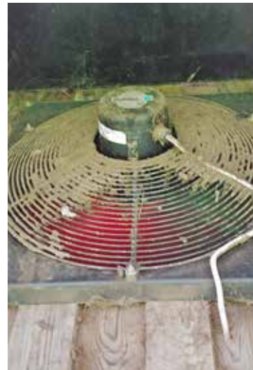
Damit Lüfter auch ihre volle Leistung bringen können, müssen sie spätestens zum Ende des Frühjahrs von Staub und Pflanzensamen befreit und gereinigt werden.
