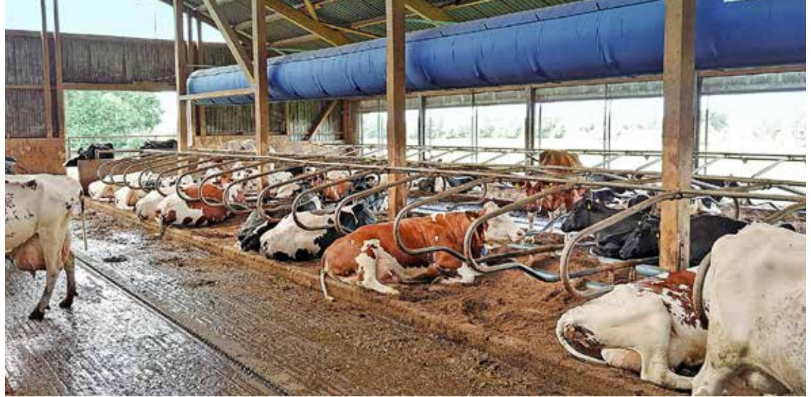
Schlauchlüftungen sind geeignet, große Luftmengen an die liegende Kuh zu bringen. Der Vorteil liegt dabei in der Tatsache, dass auch in der Mitte und am Ende des Stalles die gleiche Frischluftqualität angeliefert wird.
