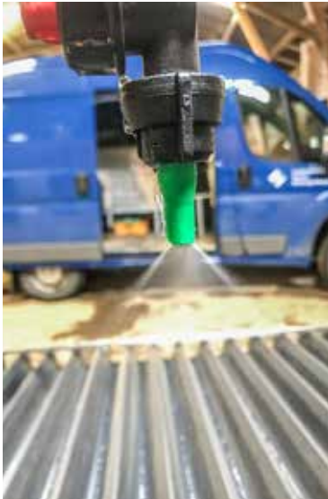
Hier ist der Tropfstopf defekt. Herunterlaufende Tropfen stören die Querverteilung und können nach der Anwendung zu Einträgen führen.
