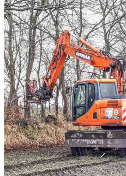
Die Knickschere kneift den Baum ab und legt ihn seitlich ab. Anschließend wird der Stumpf mit der Motorsäge in der richtigen Höhe nachgeschnitten. Fotos (4): Kerstin Ebke
